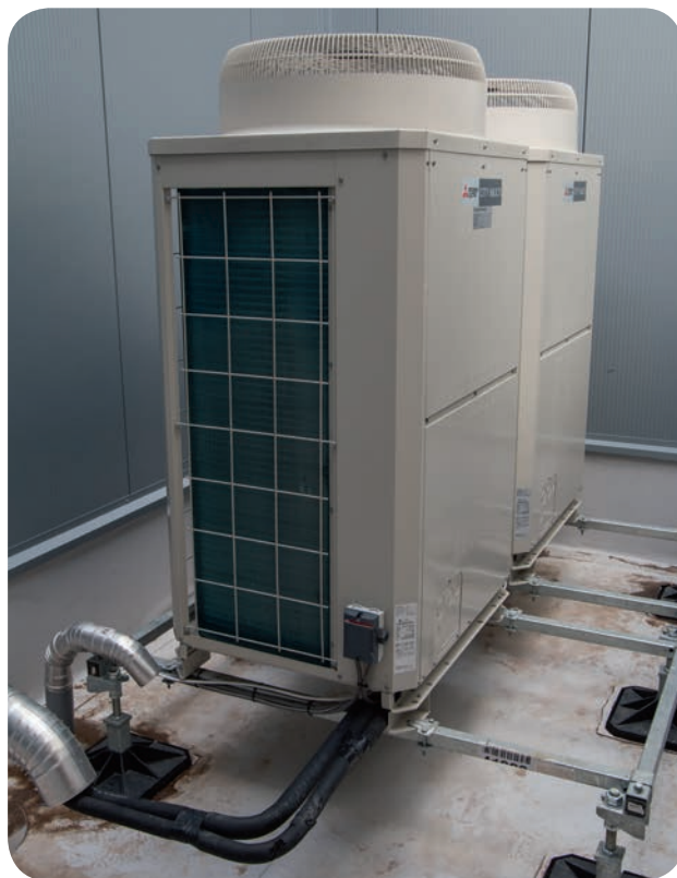
In het distributiecentrum van Prologis is gebruikt gemaakt van het City Multi VRF Klimaatsysteem.
